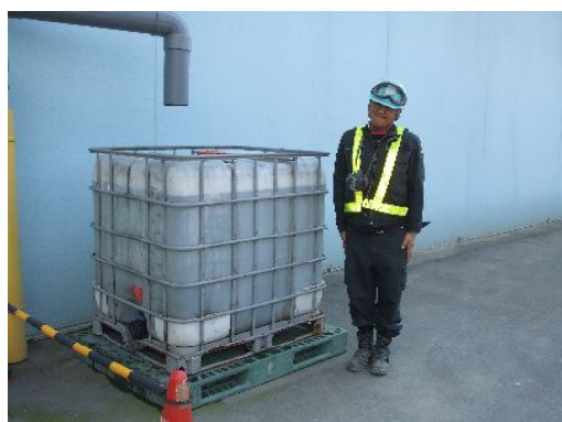
雨水再利用タンク
